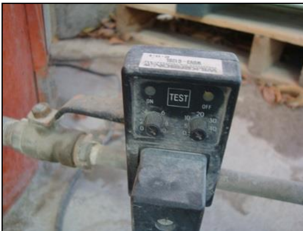
Imagen 3: Purga del tanque de compresor (presionar "test").
